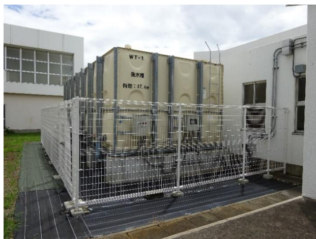
【清掃を行う貯水槽（容量70m 3 ）】
